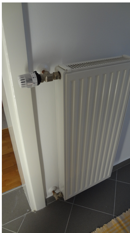
Slika 3: Ugrađeno radijatorsko ogrijevno tijelo
