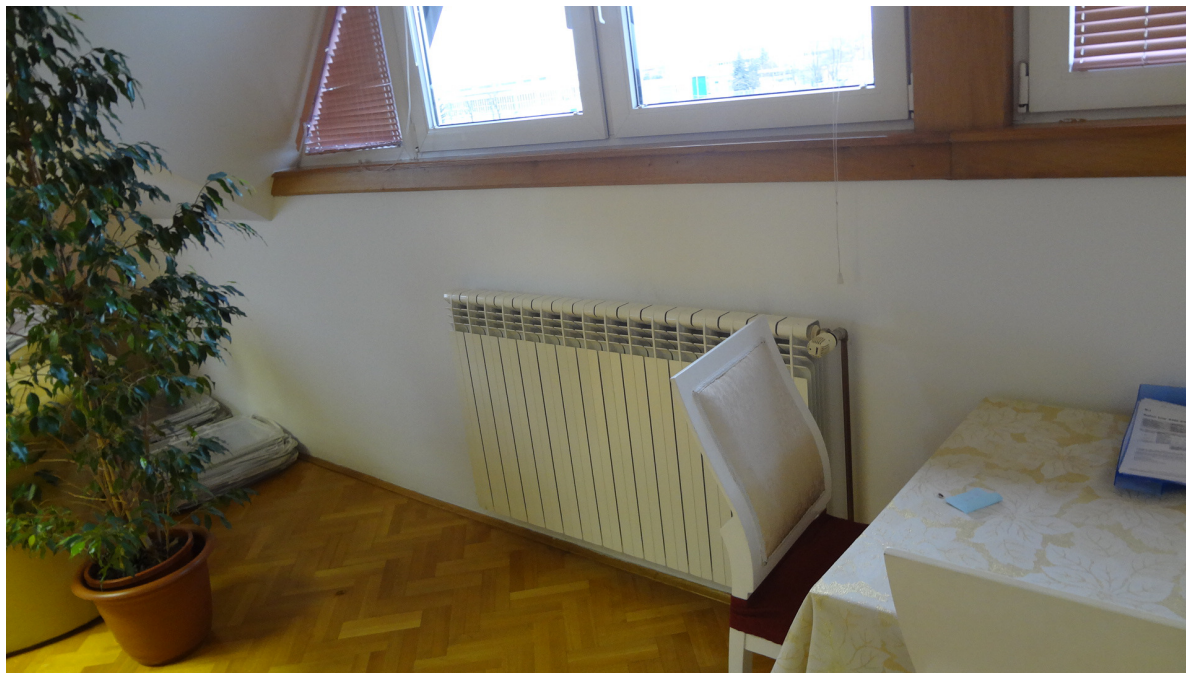
Slika 4: Primjer ugrađenog radijatora
