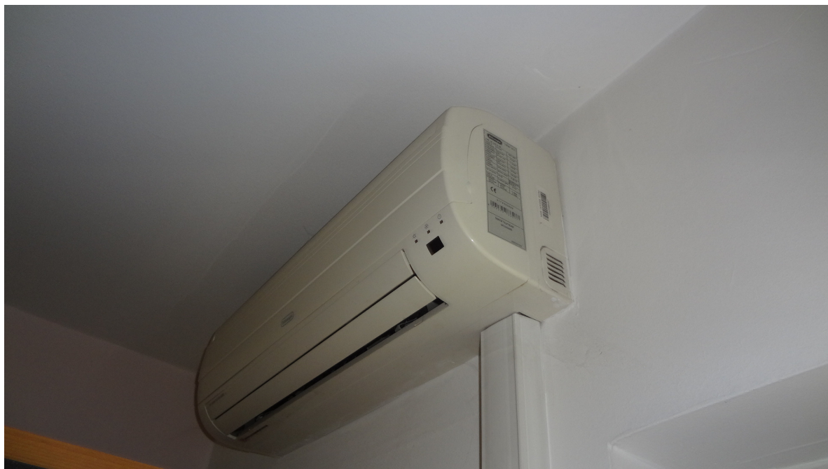
Slika 5: Karakterističan primjer ugradnje unutarnje jedinice
